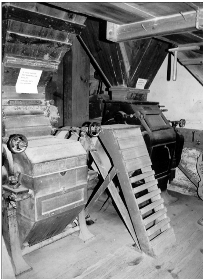
Abb. 11 Talmühle, 100-jährige Porzellan-Walzenstühle
